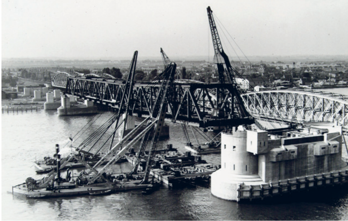
Een van de brugdelen (de vakwerkbrug) wordt op de pijlers van de verkeersbrug gehesen door vier kranen. RAD, Collectie W. Meijers, inv.nr. 555_15220.
