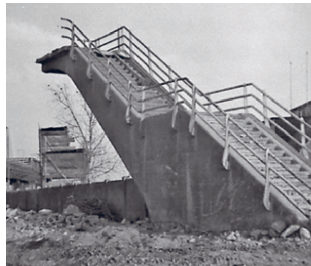
Terwijl de viaducten al gesloopt waren, stonden de trappen als enige nog overeind. Toch werden ook zij gesloopt en aan de overkant van de dijk weer opgebouwd. Foto op de facebook-pagina Oud-Zwijndrecht.
